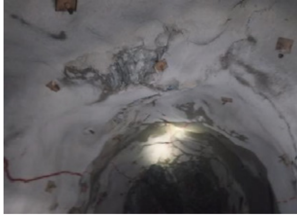
Figura 2. Labor subterránea con shotcrete craquelado a edades tempranas. Elaboración propia
